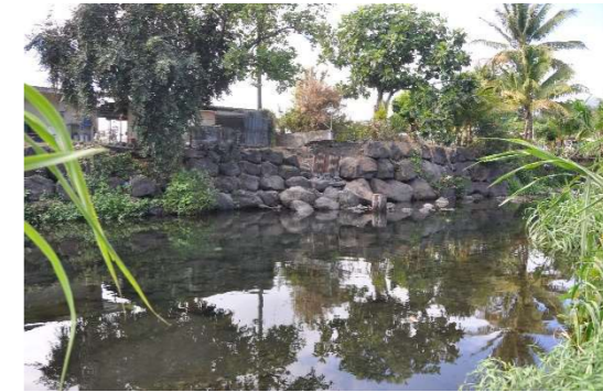
Enrochements instables dans le secteur de la plaine
