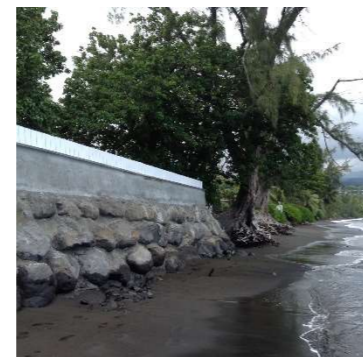
Les remblais sur le littoral provoquent une érosion de la plage
