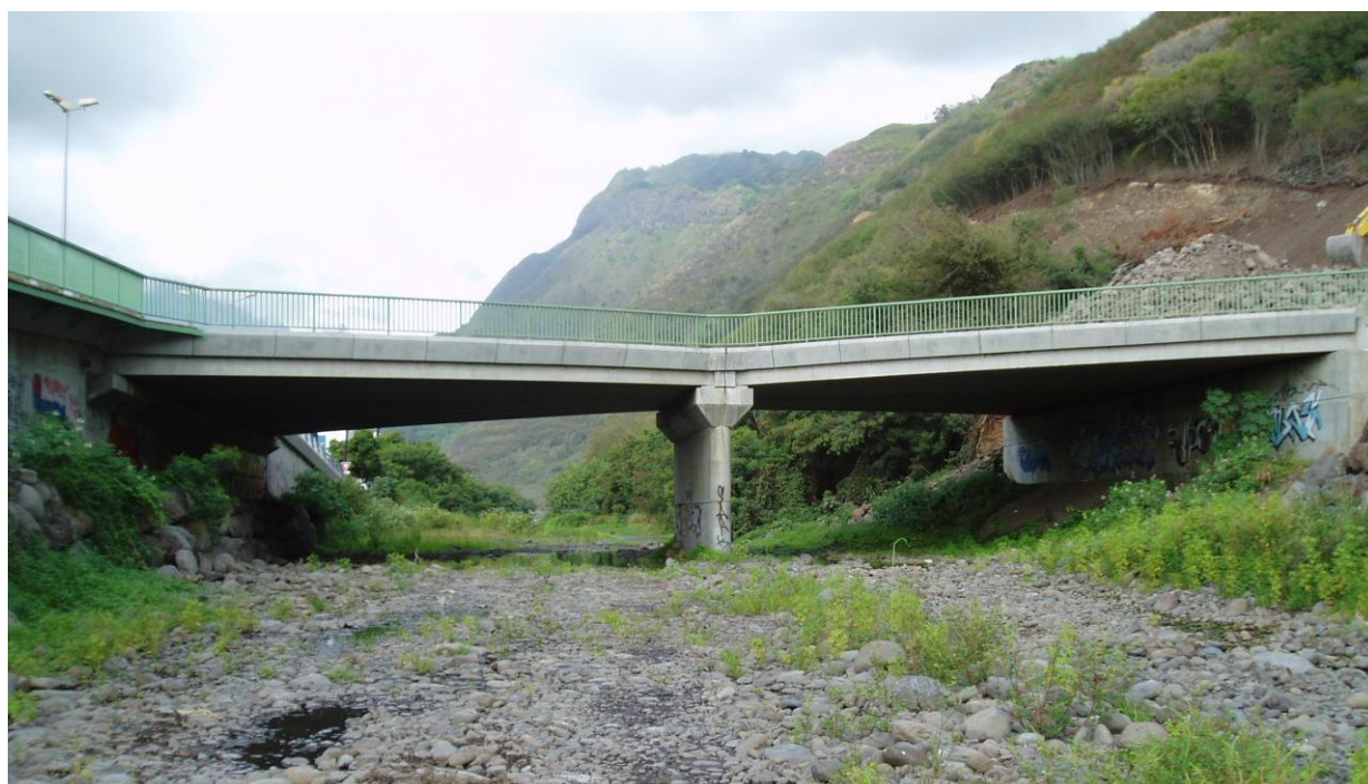
Ouvrage de franchissement de la Punaruu au droit de la zone industrielle (photo prise en septembre 2005)
