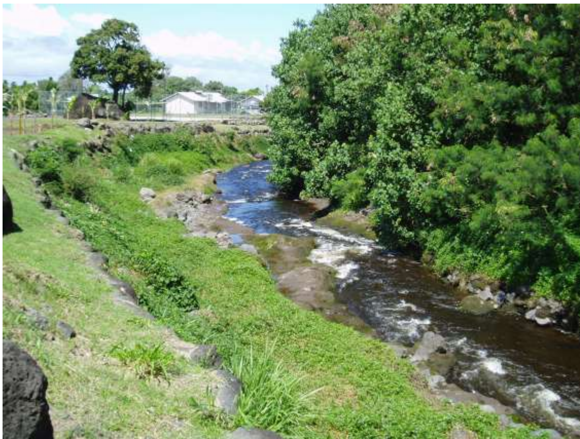
Tronçon de lit mineur protégé par des enrochements - Tamarua (photo prise en septembre 2005)
