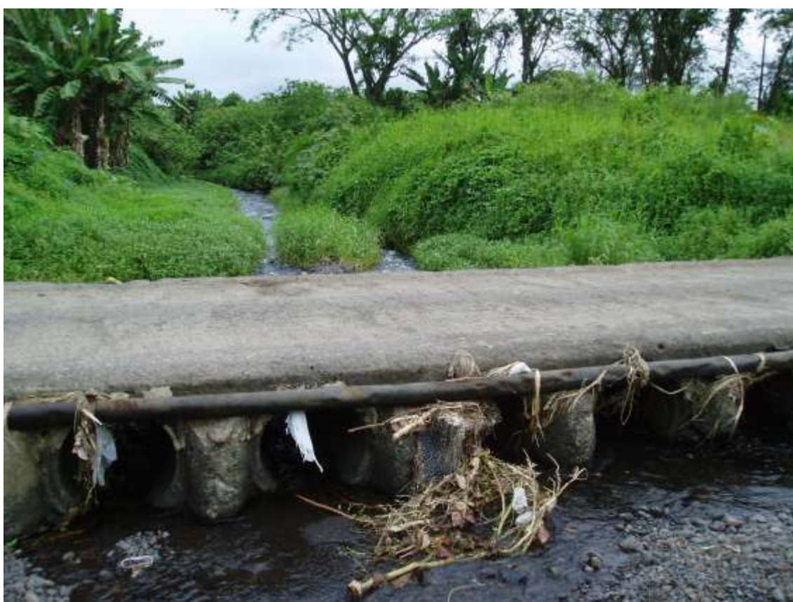
Passage à gué obstrué - Ahoaraa (photo prise en septembre 2005)
