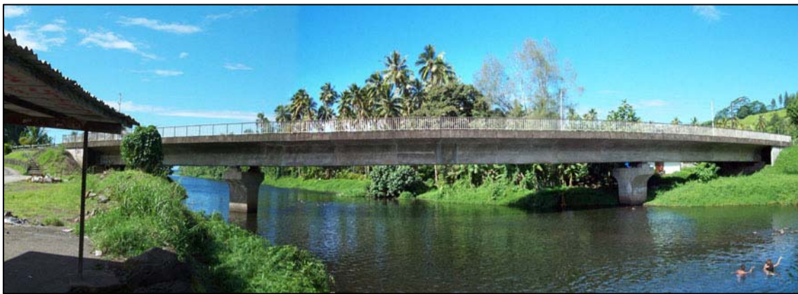
Le pont de la RT1 sur la Vaitaara à l'aval immédiat de la confluence des deux cours d'eau
