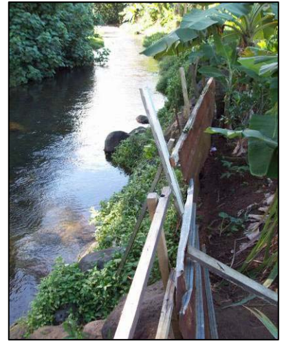
Brèches dans la digue
