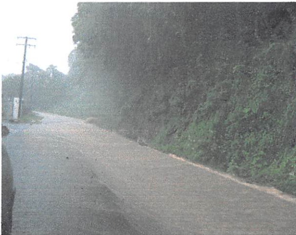
Écoulement sur la route d'accès à la vallée
