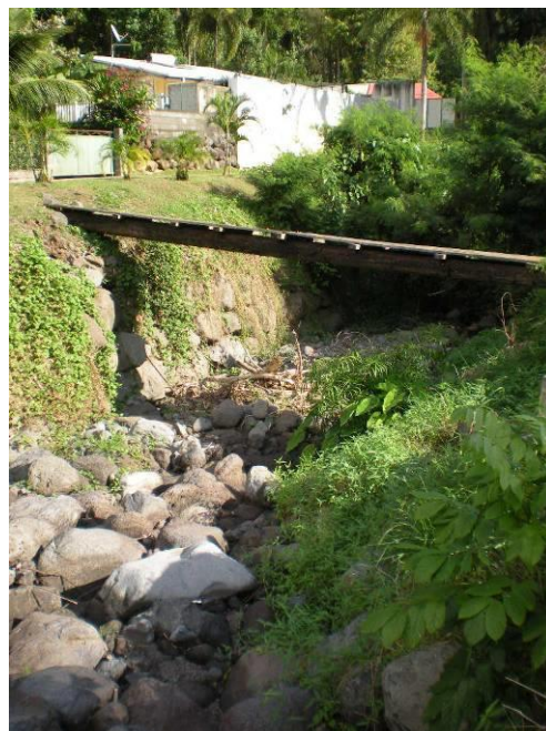
Photo 6 : Etat du lit
