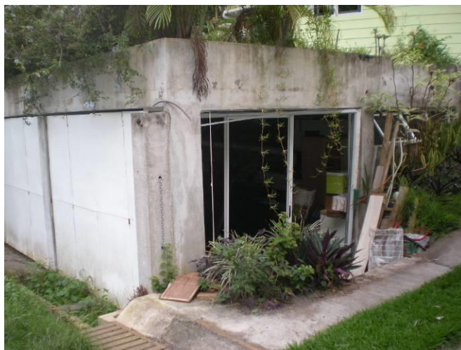
Photo 7 : Habitation M Kuntz : baie vitrée endommagée
