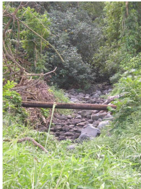
Photo 4 : Canalisation AEP traversante
