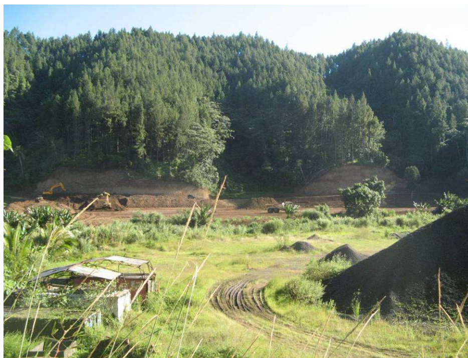
Photographie n°7 : Terrassements en rive droite en amont de la TITAAVIRI (source EGIS Eau)
