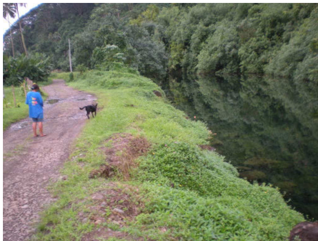
Photo 8 : Enrochements détruits rive gauche
