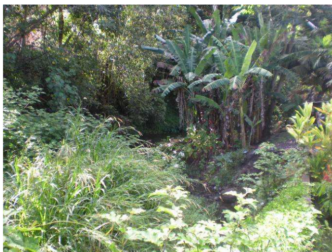
Photo 4 : Obstruction du lit dans le premier coude
