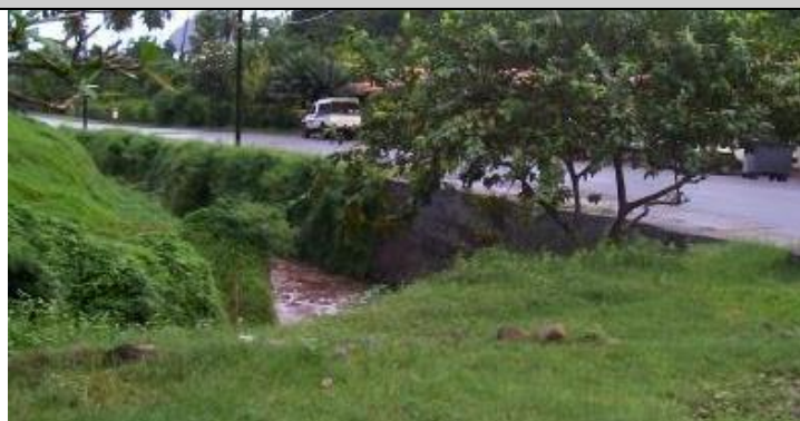
Coude marqué en aval du pont favorisant les débordements
