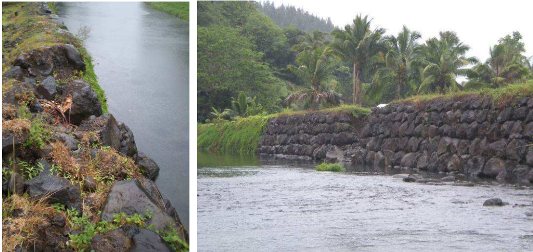
Encoche d'érosion P08-P09 et au droit du coude P115-P116
