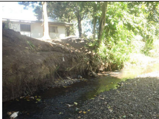
PK 1900 : Berges non protégées avec formation d'un glacis par endroit
