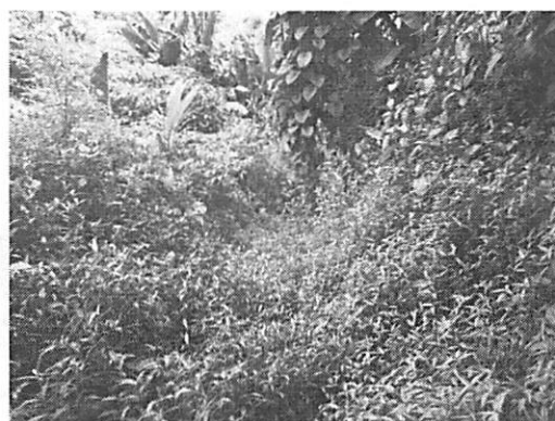
17- Lit envahi par la végétation en AL du coude vu de l'AT
