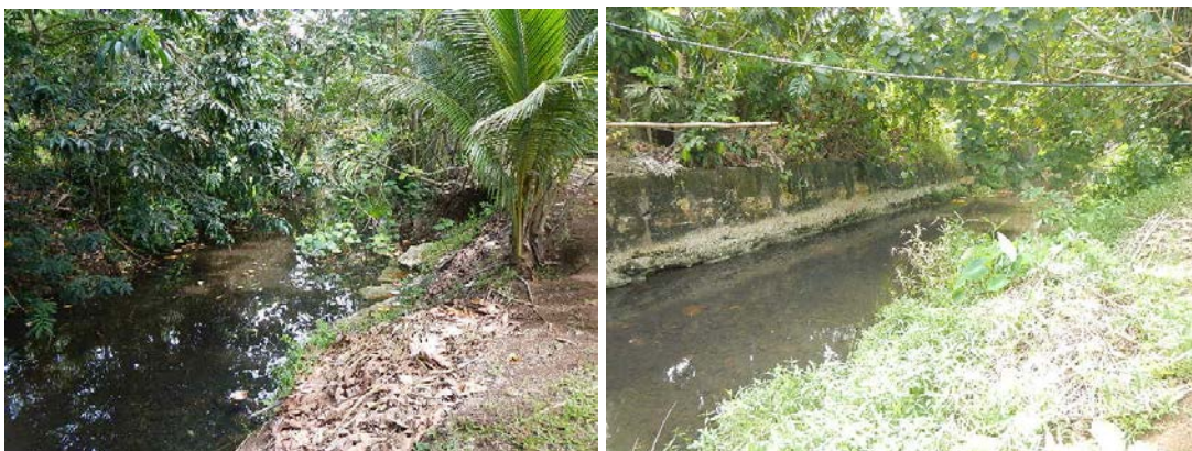
Destruction du mur en amont R1 en rive droite Sous-cavement aval radier R1
