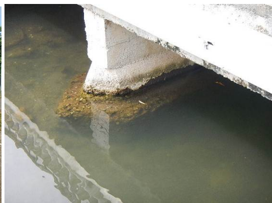
Photo 2 : vue de la pile affouillée
