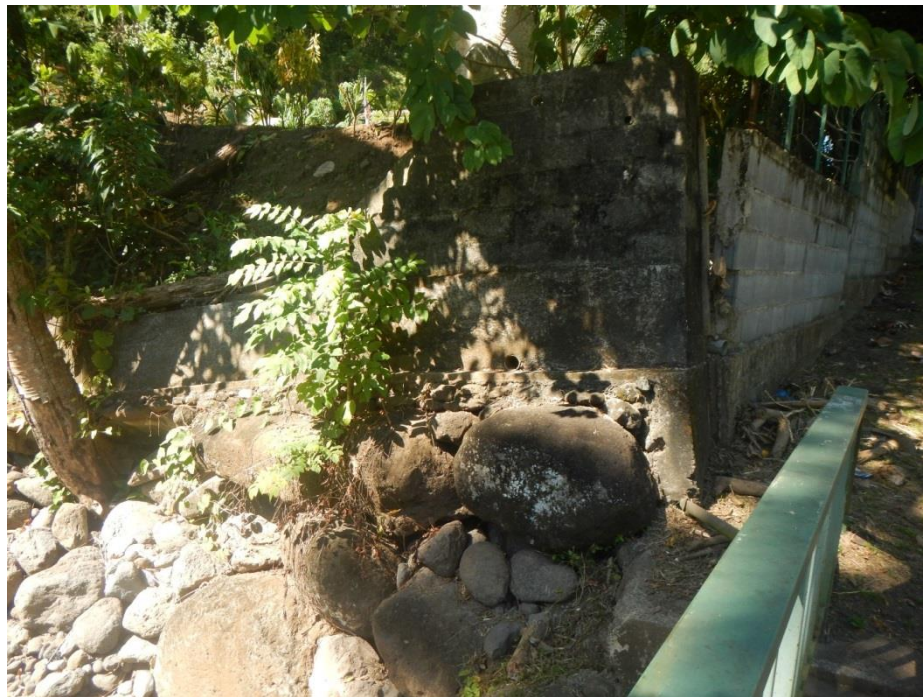
Figure 39 : Le muret à la sortie de la passerelle à gauche, subit l'action d'un mouvement du sol. La berge n'est donc pas stable.
