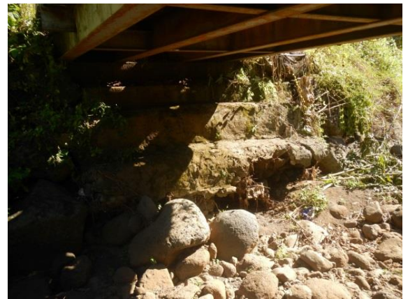
Figure 21 : Affouillement sous la culée gauche.
