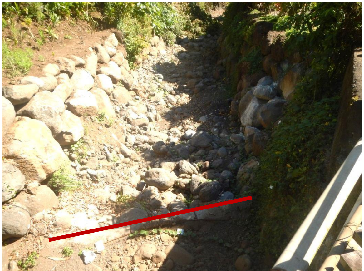
Figure 38 : Seuil à l'aval d'une passerelle avec des berges mal stabilisées.
