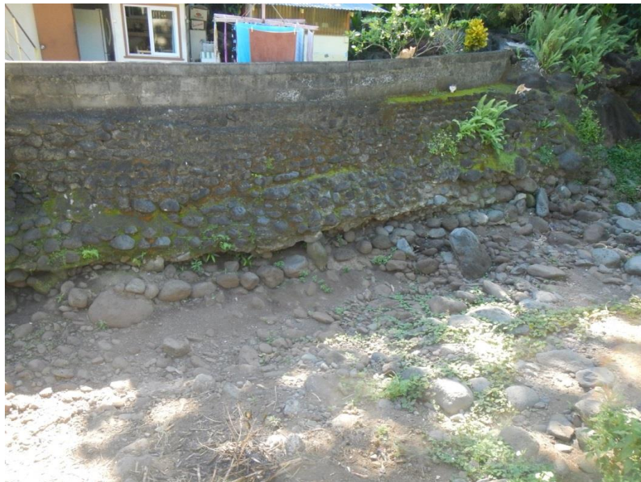
Figure 29 : Incision très nette du lit entraînant un risque d'effondrement d'un mur de protection.
