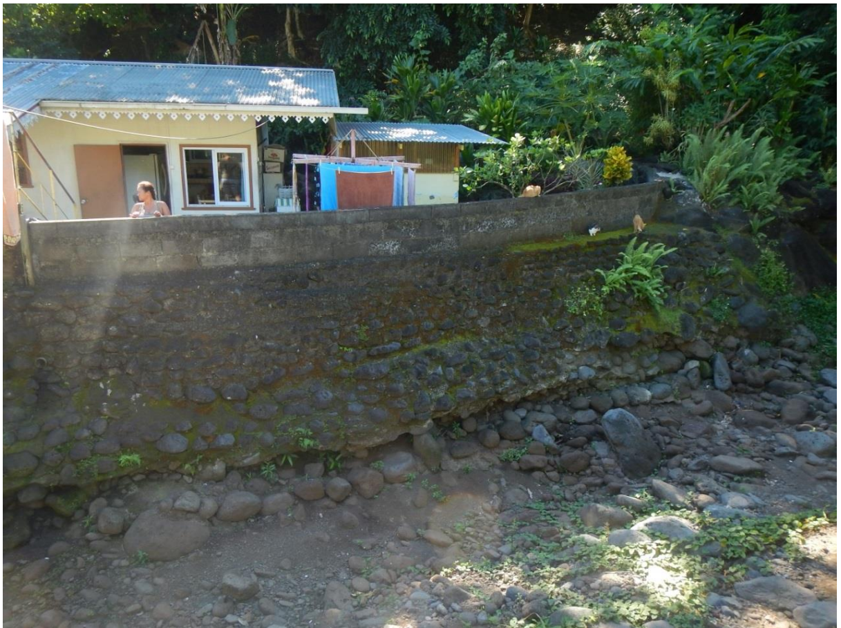
Figure 10 : Incision du lit de la rivière menaçant la stabilité d'un mur protégeant une habitation.
