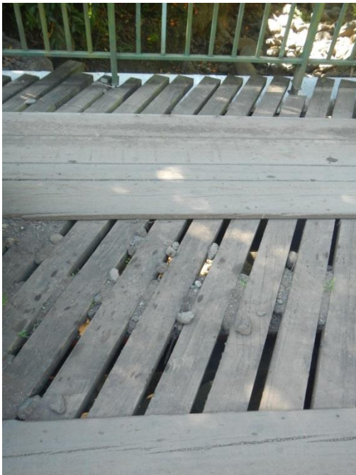
Figure 41 : Présence de terre et de cailloux sur le tablier de la passerelle.
