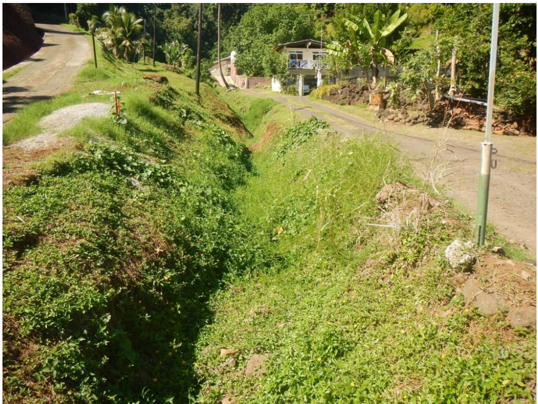
Figure 34 : Caniveau drainant un sous bassin versant de la vallée de Tefa'aroa et alimentant la rivière Pohaiatera.
