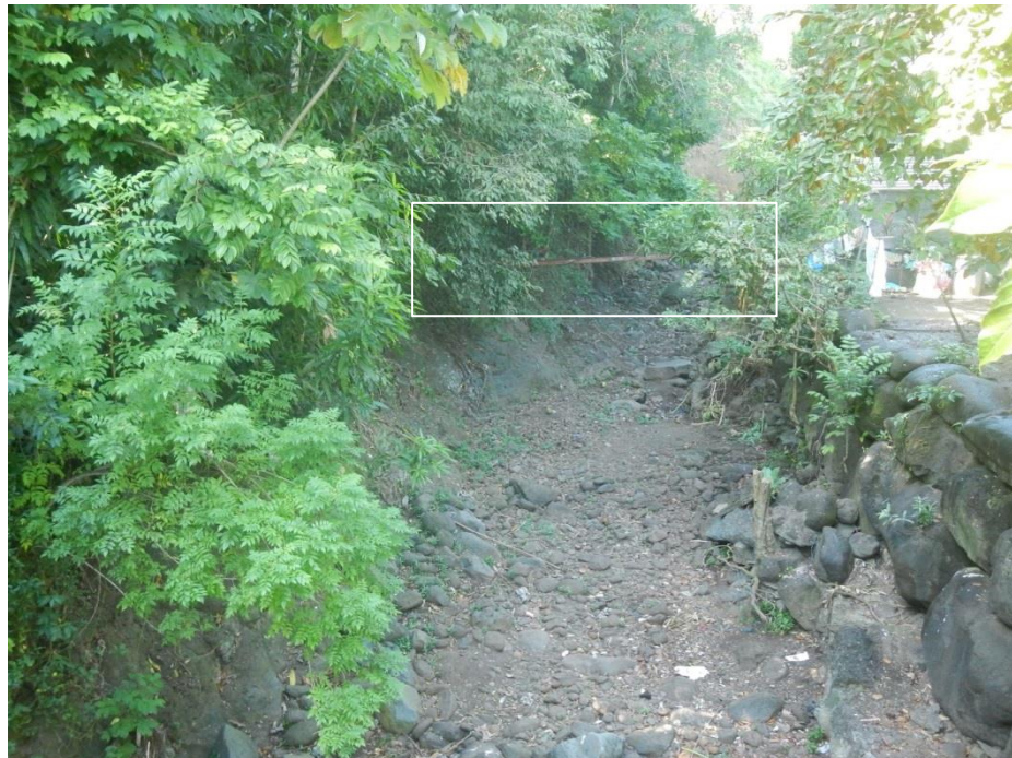
Figure 30 : Vue vers l'amont depuis une passerelle privée. Un élément de charpente métallique traverse le lit à une trentaine de mètres.
