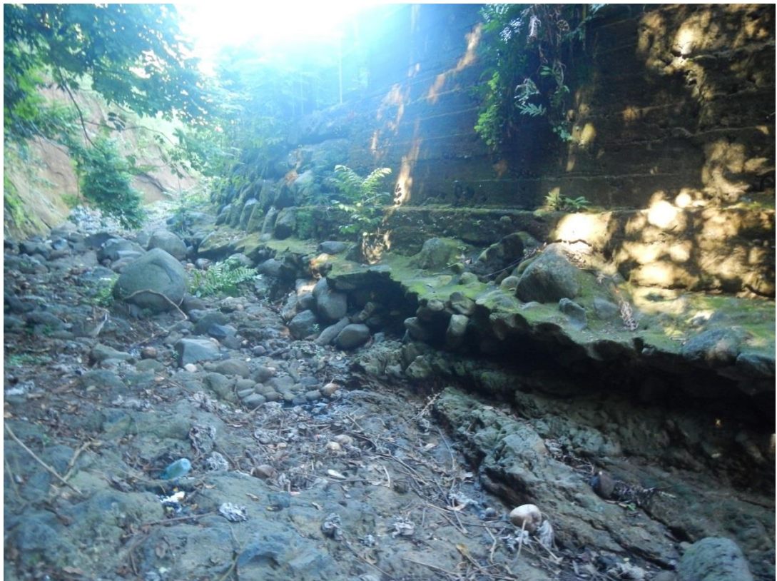
Figure 31 : En sortie de virage, un affouillement au pied de la berge gauche menace la stabilité d'un mur de protection.
