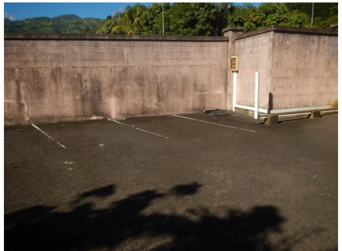
Figure 53 : Parking privé au niveau du point 3. Lors de la crue du 21 janvier 2017, l'eau aurait atteint une hauteur de 80 à 100 cm.
