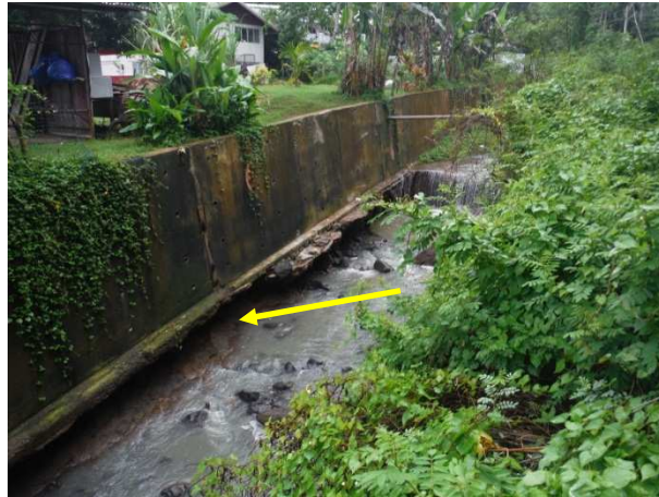
Figure 6 : exemple de départ d'érosion en pied de berge sur la MAKE MAKE (rive gauche pt 1.2)
