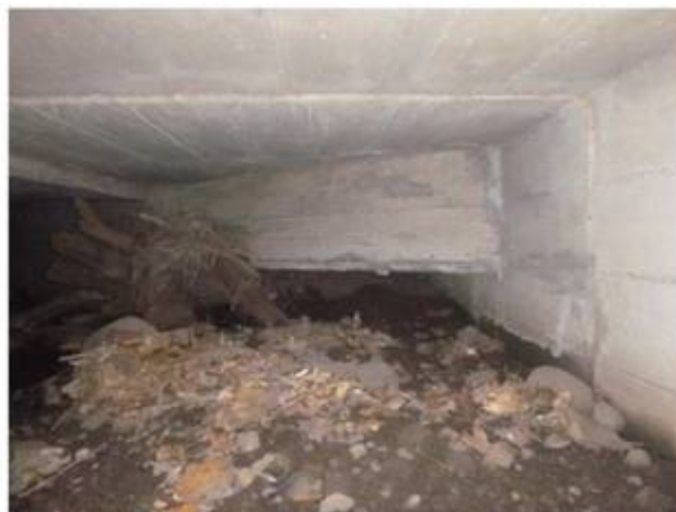
Figure 1-16 : Dépôts importants et embâcles au droit de la diffluence (source photoVAIAD – 2015)
