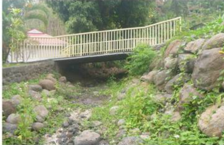
15 – Passerelle OH23.5, dépôts terrigènes contre les culées
