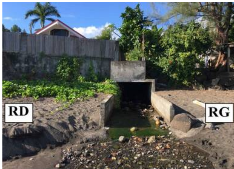
Figure 1-18 : Bras de décharge de la rivière Pipine et débouché en mer (en haut source photos VAIAD 2015 et en bas mission terrain H20-2020)
