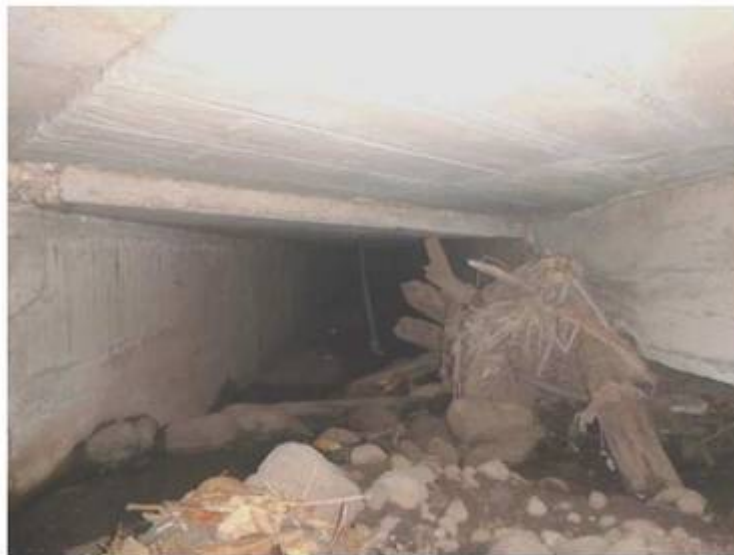
Figure 2-5 : Phénomène de dépôts et d'embâcle au droit de la diffluence sous la RDC (source photo VAIAD – 2015)
