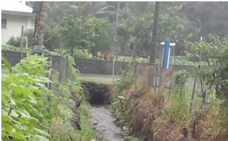
Figure 8 Passage busé de l'affluent 3 insuffisant et s'obstruant facilement
