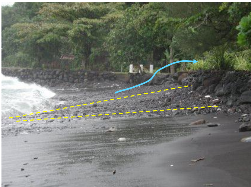
Figure 9 : Enrochement, remblai et route en haut de plage. Accumulation de galets (tirets jaunes) contre les enrochements protégeant la route dans le secteur de Vairao, lors d'une houle de 3-4 m de direction S-SW (Des Garets 2005). Ce prisme favorise le franchissement de l'ouvrage (symbolisé par la flèche bleue).
