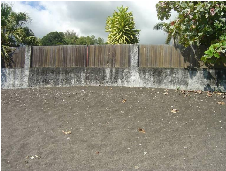
Figure 25 : Mur avec palissade en haut de plage sans remblai (ou faible épaisseur de remblai ; Arue, Commune d'Arue Aire de loisir Vaipoopoo, photo C. Chene)
