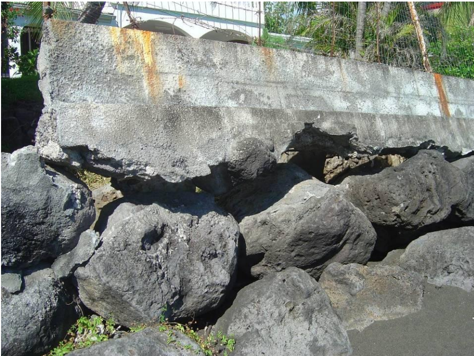
Figure 27 : Exemple de dégradation et déchaussement d'aménagements par attaque de vague et érosion en haut de plage. Le manque d'entretien des aménagements compromet fortement leurs fonctions (Commune d' Arue, plage Lafayette, ph. C. Chene)
