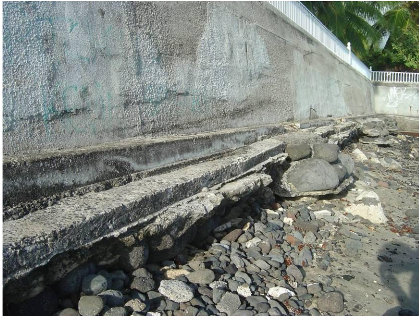
Figure 32 : Dégradation et déchaussement en haut de plage de la base d'un mur par érosion de la plage
