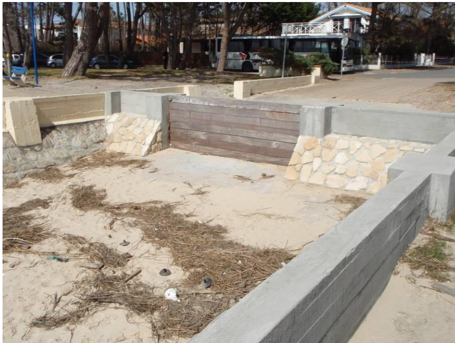
Figure 39 : Réhausse de muret et fermeture provisoire d'accès à la plage par batardeau (Andernos-les-Bains, Photo Observatoire de la Côte Aquitaine)
