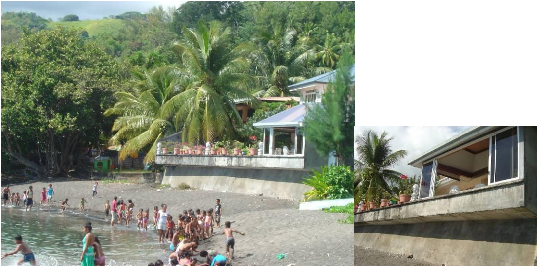
Figure 24 : Aménagement privé, mur en béton et haut de plage et remblai (Commune d'Arue Aire de loisir Vaipoopoo, photo C. Chene)
