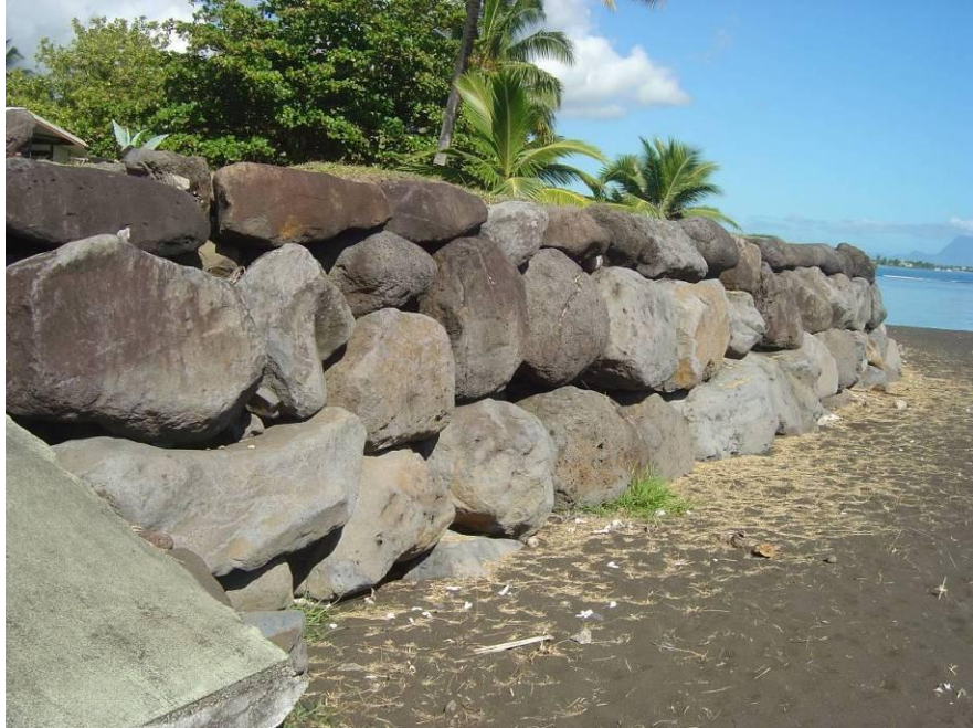
Figure 22 : Mur en enrochement de haut de plage avec remblai et enjeux en arrière (Commune d'Arue Plage Lafayette, photo C. Chene)
