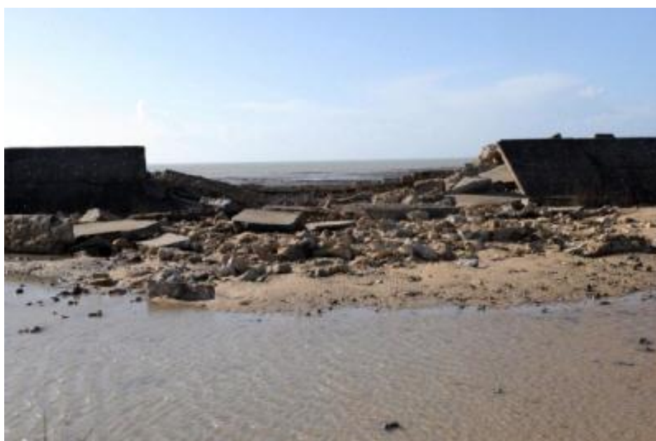
Figure 34 : Brèches dans les digues suite au passage de la tempête Xynthia (2010) : brèche dans la digue marine du Marais de Guérande (haut), destruction d'une digue sur l'île de Ré (bas)
