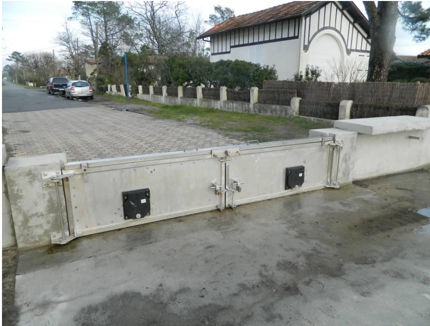
Figure 40 : Installation de porte étanche suite à Xynthia (Andernos-les-Bains, , Photo Observatoire de la Côte Aquitaine)
