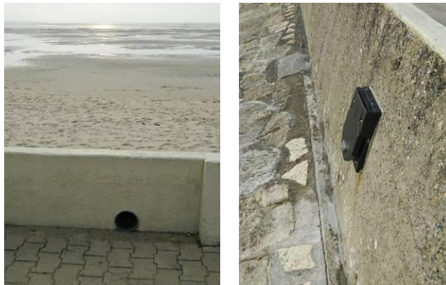
Figure 41 : Buse d'évacuation équipé d'un clapet anti-retour coté océan à Andernos-les-Bains (Photo Observatoire de la Côte Aquitaine)
