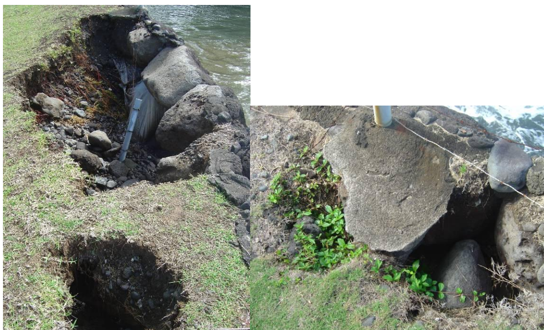
Figure 29 : Affouillement et érosion des remblais situés en arrière des enrochements par déferlement au-dessus de l'ouvrage (Parara, face à la passe de Rairoa, Ph. C. Chene)
