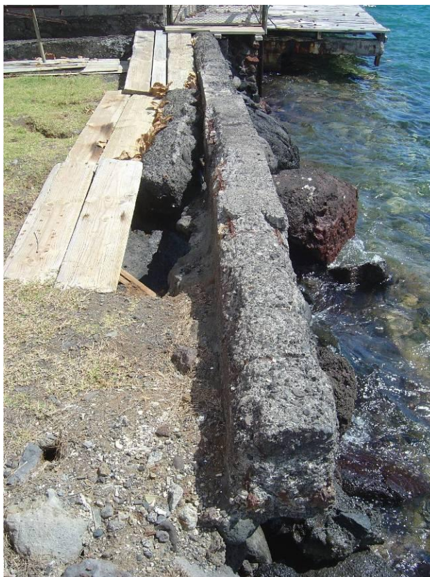
Figure 30 : Très forte dégradation d'un muret en béton et affouillement des terrains en arrière de l'ouvrage (Pirae)
