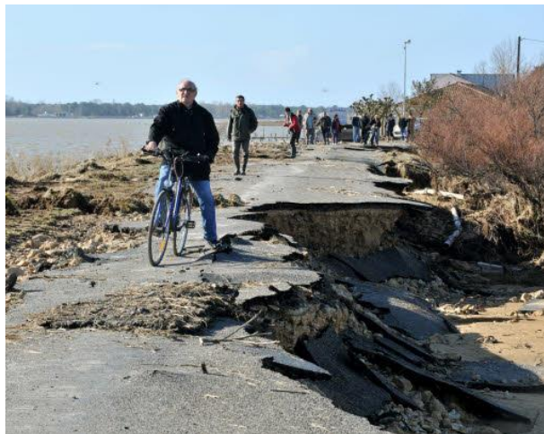
Figure 35 : Brèches et fortes dégradations de la digue de l'Aiguillon lors de la tempête Xynthia (2010)
