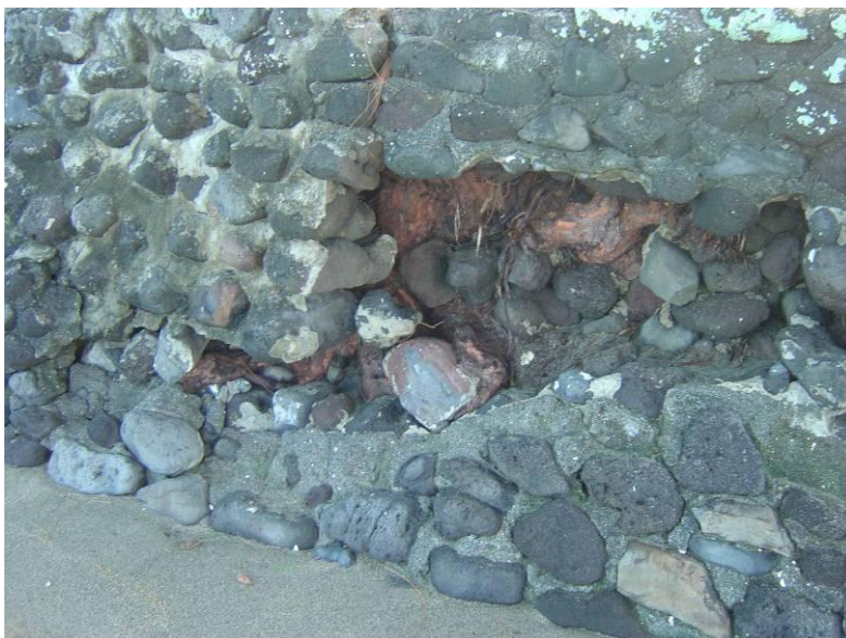
Figure 28 : Dégradation dans un mur de haut de plage maçonné par attaque directe des vagues (Papara, Ph. C. Chene)
