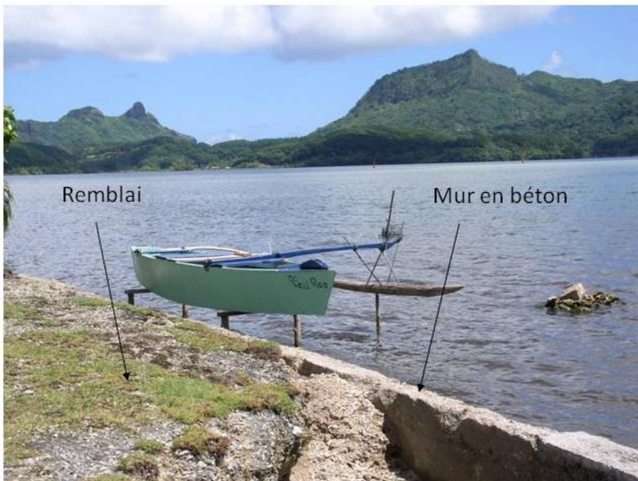
Figure 17 : Aménagement littoral public de petit fond en mur béton et remblai (Huahine 2006, Ph. M. Garcin) A noter les affouillements du remblai en arrière du mur en béton
