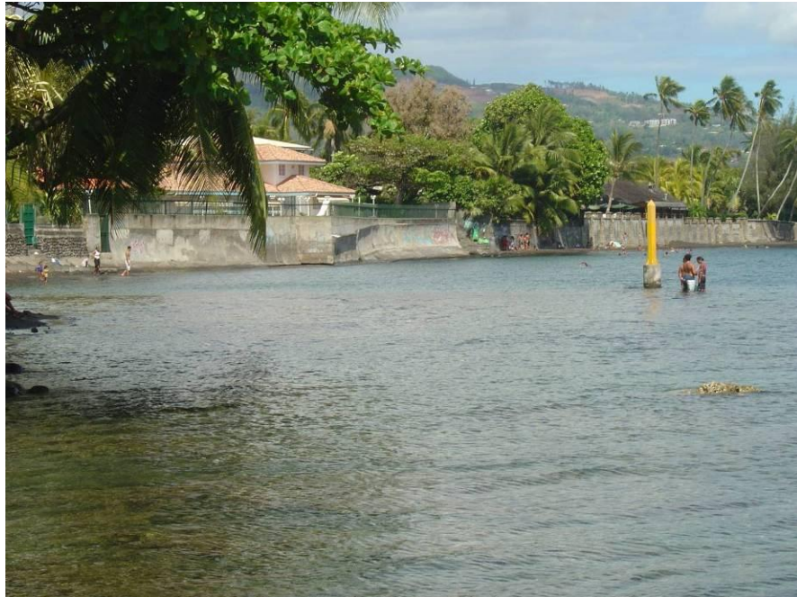
Figure 18 : Succession continue en petit fond de murs en béton avec remblai et enjeux en arrière (Pirae, Ph. C. Chene)
