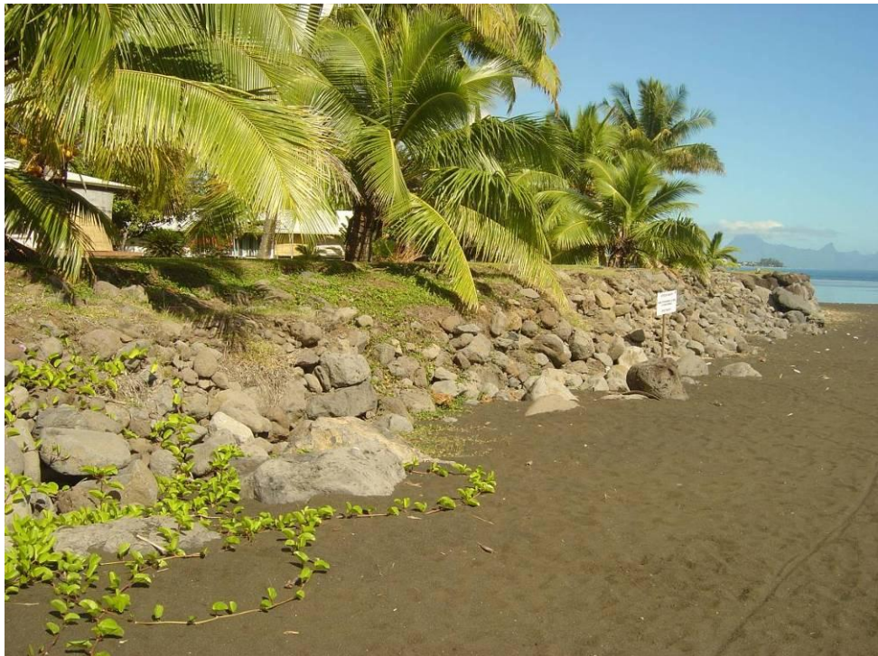
Figure 23 : Enrochement incliné et fortement dégradé de haut de plage (photo C. Chene)
