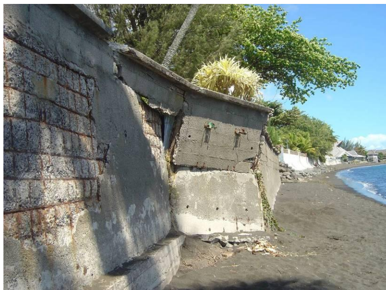
Figure 31 : Très forte dégradation d'un mur béton en haut de plage (Pirae, Ph. C. Chene)
