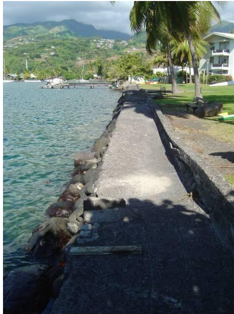
Figure 15 : Petits enrochements de faible altitude avec promenade et muret sur remblai (Commune d' Arue, ph. C. Chene) La dégradation du muret est à noter
