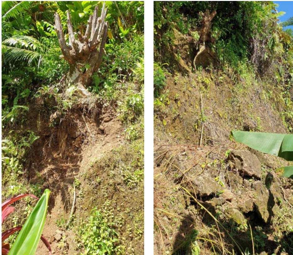
Figure 1 : Exemples de petits glissements ayant récemment eu lieu derrière le mur de clôture de la maison, au niveau de la souche d'un falcata (photo associée au point GPS n° 187).
