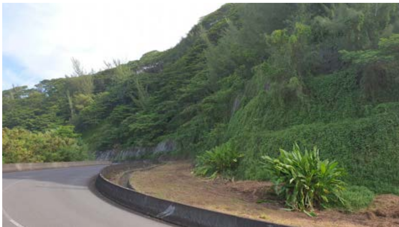
Figure 4 : Vue générale sur les aménagements effectués en bordure de la route ceinture. La zone où la paroi est grisâtre correspond à la paroi gunitée (photo associée au point GPS n° 228).
