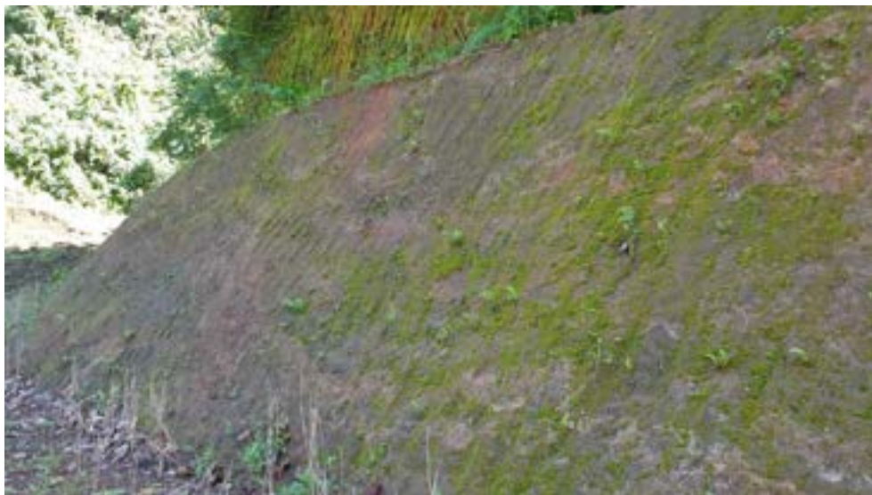
Figure 3 : Basalte altéré en mamu de type IV et présentant une altération caractéristique en pelures d'oignon (photo associée au point GPS n° 179)
