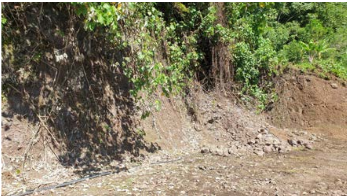
Figure 6 : Eboulement de date inconnue survenu au niveau d'aménagement en terrasse (photo associée au point GPS n° 128, évènement répertorié dans la BD_MVT).
