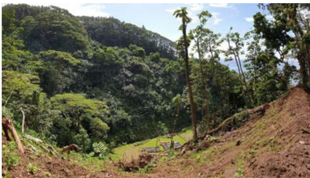
Figure 4 : Exemple de défrichement causé par la construction de la route. Ce défrichement a déstabilisé le versant qui n'est plus retenu par la végétation (photo associée au point GPS n° 393).
