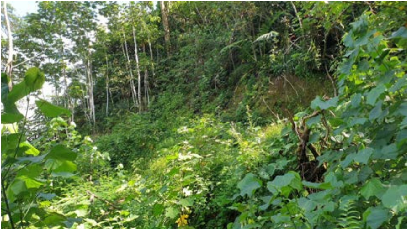
Figure 3 : Partie latérale de la zone d'arrachement du glissement de 2021 (photo associée au point GPS n° 211)
