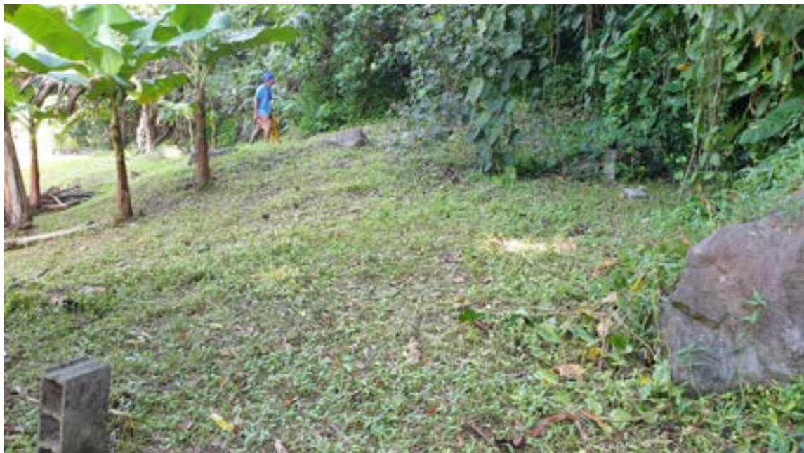
Figure 2 : Falaise subverticale de 8m constituée d'un niveau basaltique, fracturé en blocs métriques à pluri-métriques. Présence d'un cône de colluvions en pied de falaise avec des blocs au sol qui témoignent d'un ancien éboulement (photo associée au point GPS n° 456).
