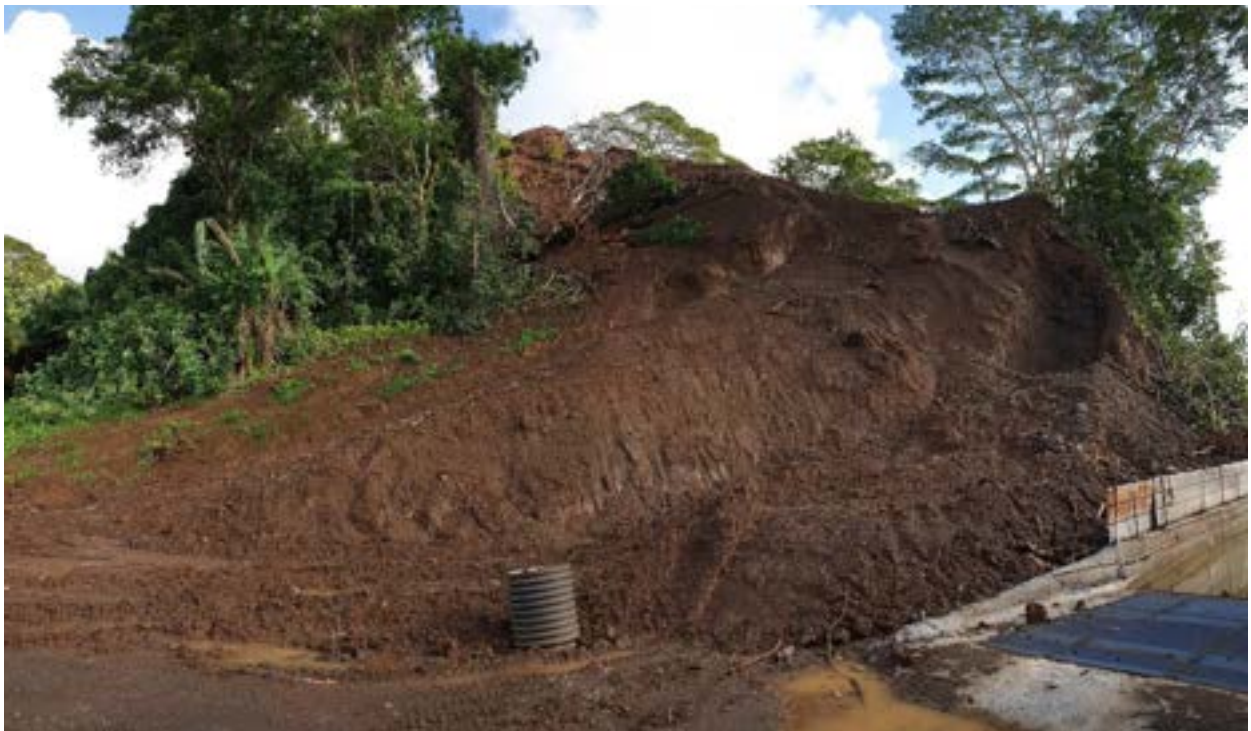
Figure 4 : Imposant cône de débris de glissements constitué de faciès meuble de mamu III et IV visible en pied de la falaise. Les dépôts sont particulièrement bien exposés grâce aux travaux d'aménagement de la route (photo associée au point GPS n° 343).
