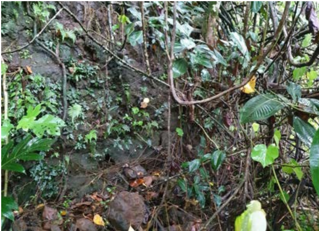
Figure 3 : Basalte altéré et fracturé en pied de falaise sur une hauteur d'au moins 5 m. Quelques blocs de taille décimétrique sont observés en pied de falaise (photo associée au point GPS n° 385).
