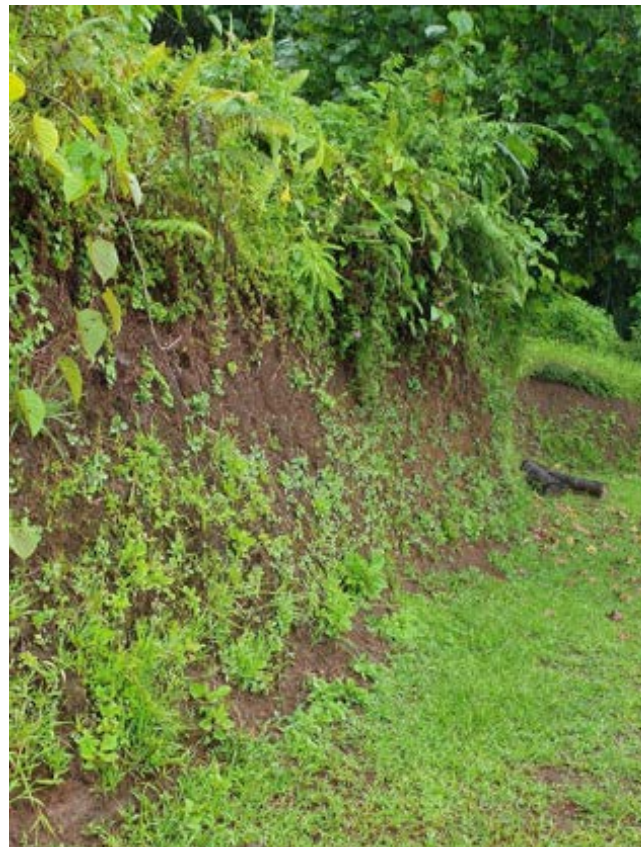
Figure 4 : Exemple de dépôts d'anciens glissement mis à l'affleurement par le talus (photo associée au point GPS n° 401).
