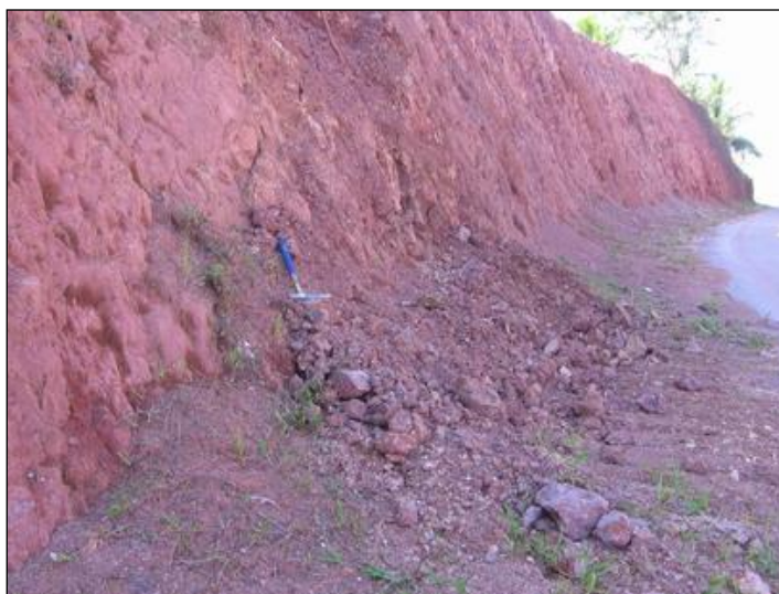
Figure 6 : Petits éboulements le long de la route de l'aéroport.
