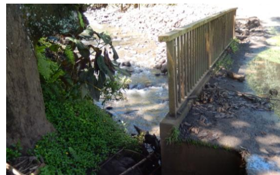
Endommagement de la tête d’un pont sur la rivière Orofara
