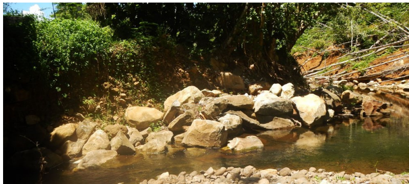
Figure 68 : Enrochement mal réalisé qui s'est totalement affaissé. Raiatea, 2016.
