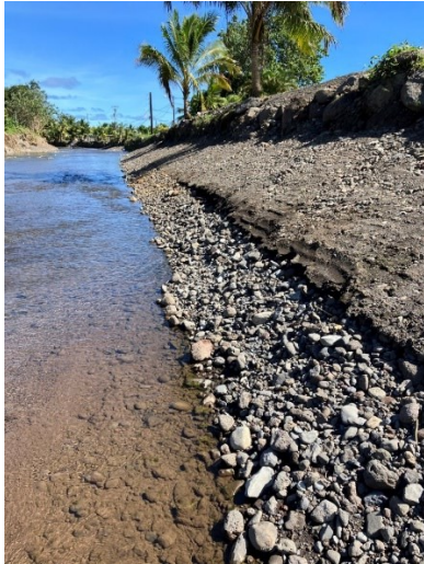
Figure 25 : Photo P9, amas d'alluvion posé contre la berge droite par les services de l'équipement après la crue du 1er mai.
