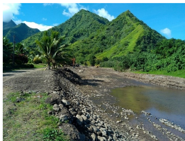
Figure 32 : Photo P15 - Servitude de desserte du fond de la zone habitée, reconstituée après la crue du 1er mai 2023.
