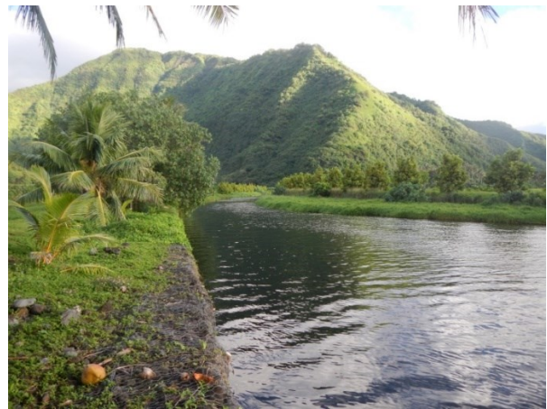
Figure 74 : Soutien de berges par gabions. Vallée Aiurua, Tahiti.
