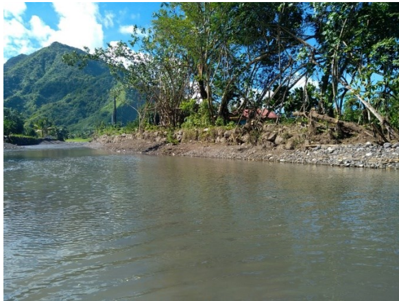
Figure 21 : Photo P5, partie amont de la section avec des Purau. La berge est consolidée avec un enrochement assez ancien et instable.
