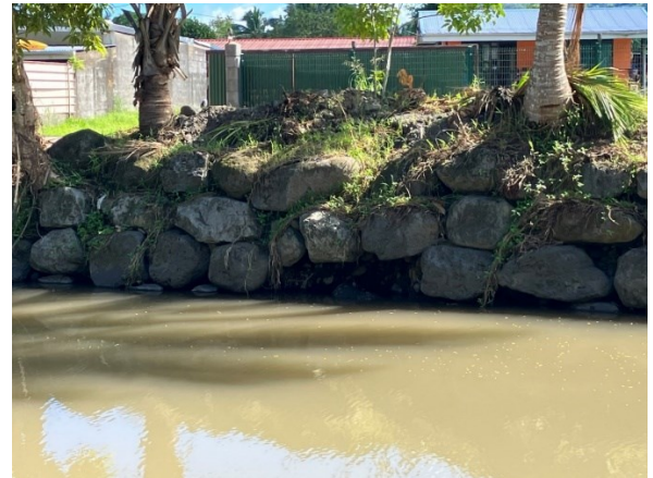
Figure 22 : Photo P6, l'enrochement rive droite est par endroit instable avec des blocs qui se sont décrochés.
