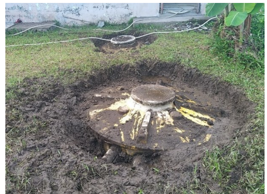
Figure 51 : Système épuratoire submergé et déplacé lors de la crue du 1er mai.
