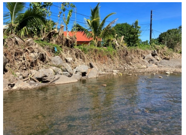
Figure 24 : Photo P8, l'enrochement s'est totalement affaissé et la berge gauche a été fortement endommagée sur cette section juste à l'aval du gué.
