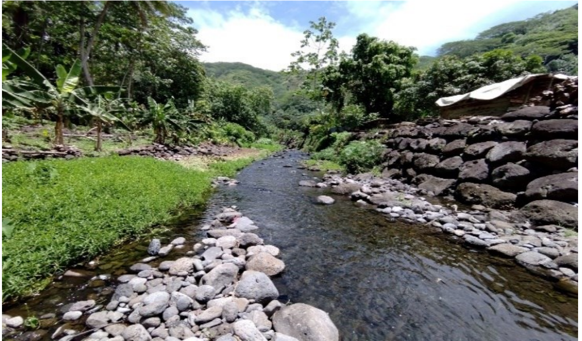
Figure 41 : Aménagement récent de la Berge Gauche, concave, dans le coude à 70 m à l'aval de la passerelle P6. Cet ouvrage répond aux recommandations de 2012, mais il ne permet toujours pas de contenir une crue cinquantennale.
