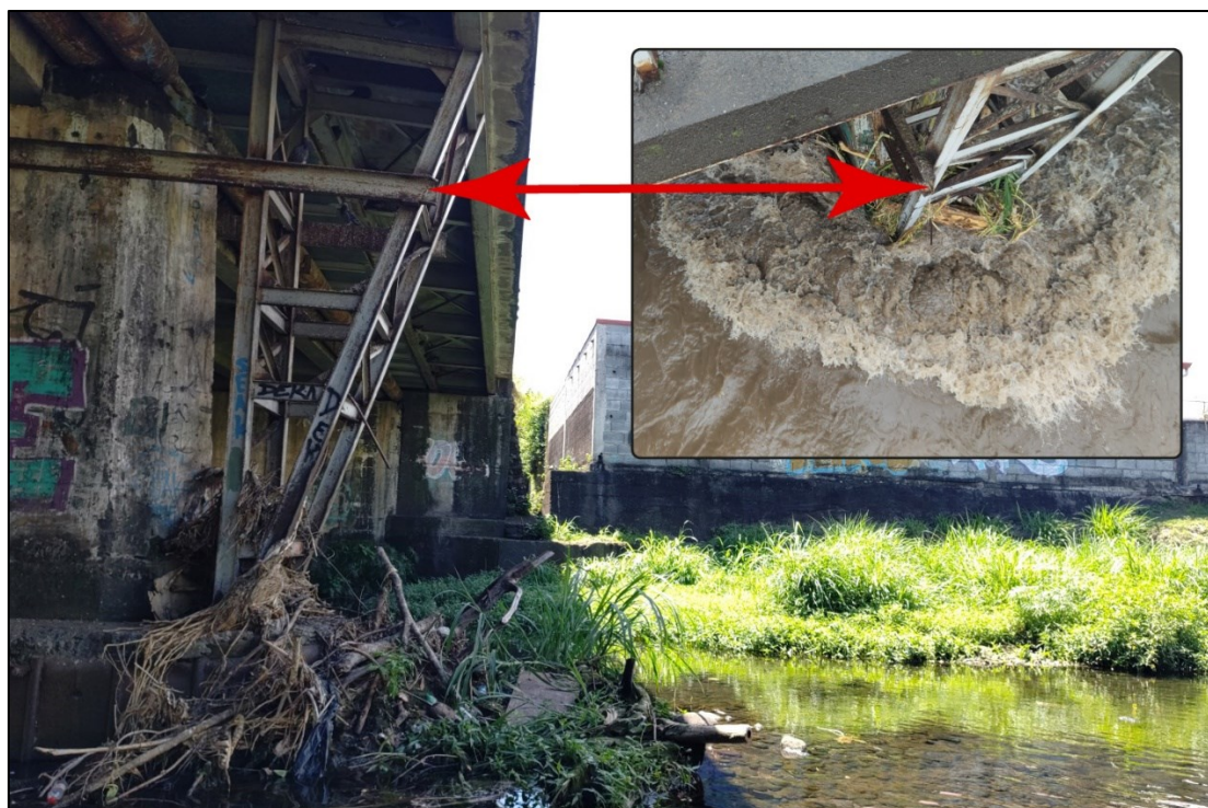
Figure 27 : Observation de la crue du 12 février au niveau de la pile centrale du pont de la RT2. Cliché pris 5 heure après le pic de l'onde de crue.
