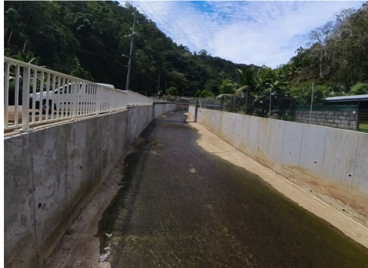
Figure 36 : Canal d'écoulement sur la section 3 de la rivière. Le lit est contraint dans un espace géométrique trop étroit pour les crues très importantes.
