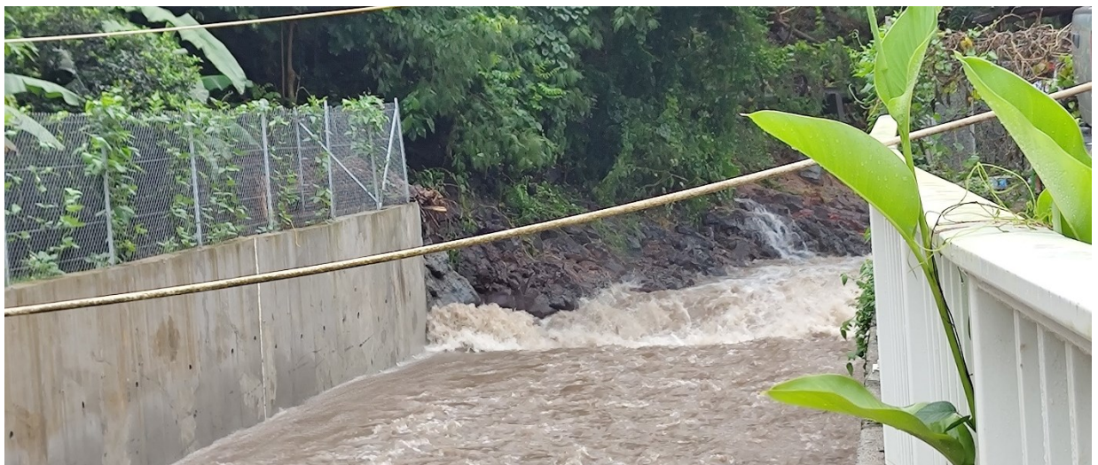
Figure 37 : Phénomène d'érosion en cours à l'aval d'un tronçon rectifié et bétonné (12 février 2024).
