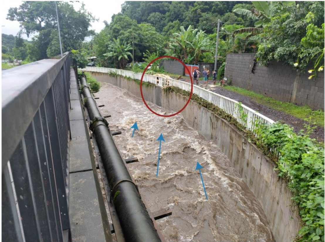
Figure 34 : Point de débordement en rive droite à l'aval du pont O10 avec la crue du 12 février 2024. La photo a été prise environ 5 heures après le pic de l'évènement.
