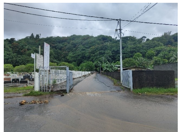
Figure 25 : Ecoulement de l'eau sur la servitude et sur la route de desserte.
