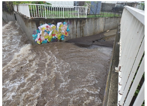
Figure 31 : Rampe d'accès à la rivière immédiatement à l'amont du pont O22. La photo a été prise 5h après le pic de crue du 12 février 2024.
