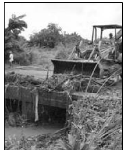
Embâcles végétales sur la RT
