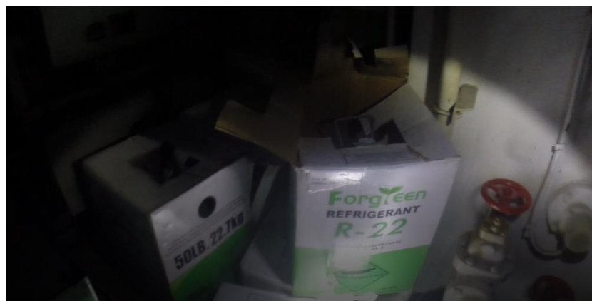
Fig 27 : Bonbonnes de gaz réfrigérant R22 stockées en carton en salle machine
