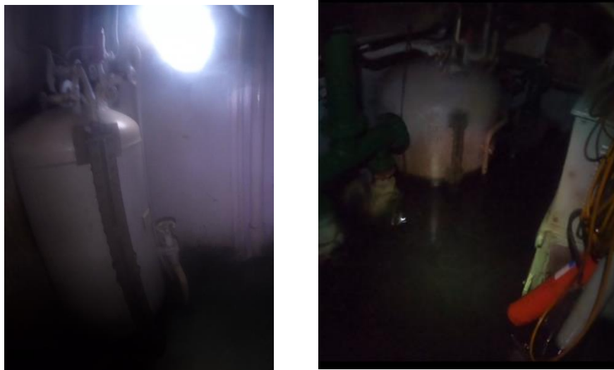
Fig 26 : Stockage de gaz frigorifiques en partie haute et basse (zone inondée huile) de la salle des machines
