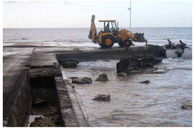
Takume : état du quai médiocre
