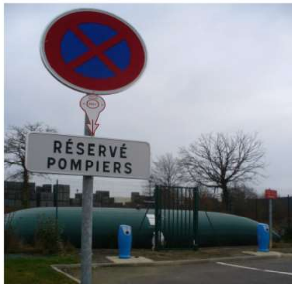
Réserve souple avec poteau d'aspiration
