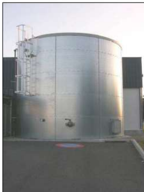
Réserve d'eau incendie aérienne, avec une sortie de 100 mm
