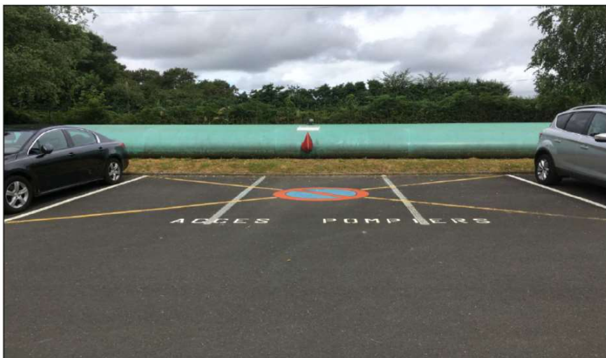
Réserve d'eau souple avec une prise directe de 100 mm
