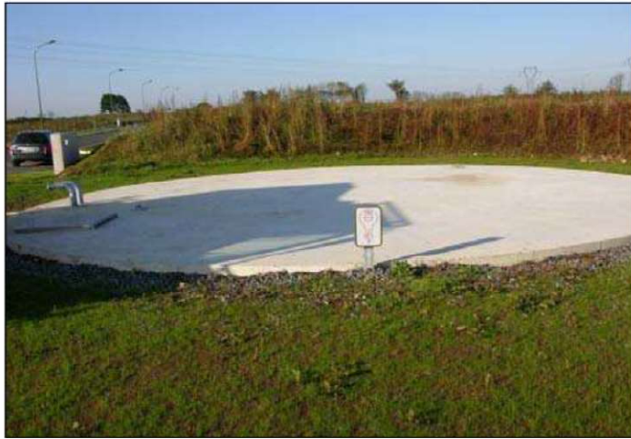
Réserve d'eau enterrée avec 2 colonnes d'aspiration
