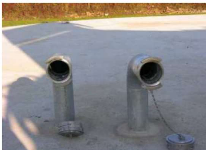
Deux colonnes d'aspiration de 100 mm une réserve d'eau enterrée
