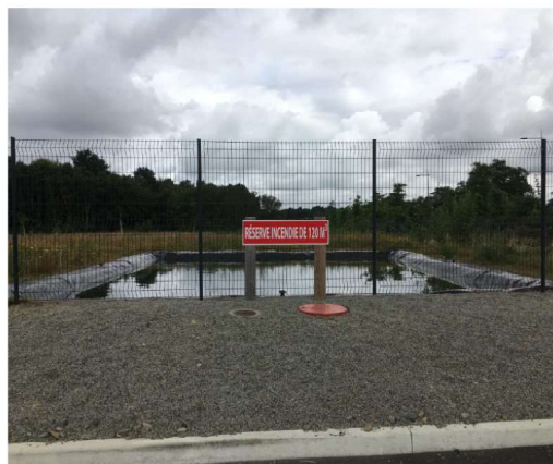
Réserve d'eau ouverte avec puisard d'aspiration
