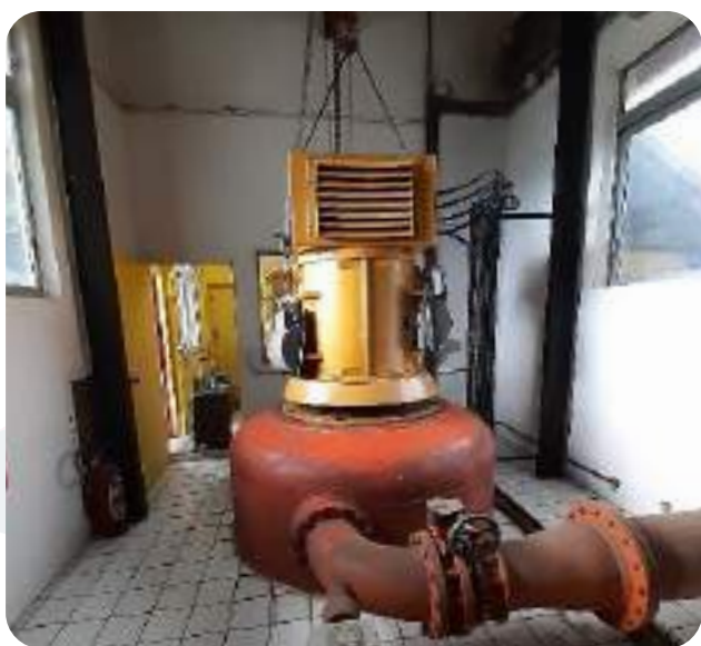
Centrale de production hydroélectrique à Fatu Hiva (Crédit © Vivien Martineau)
