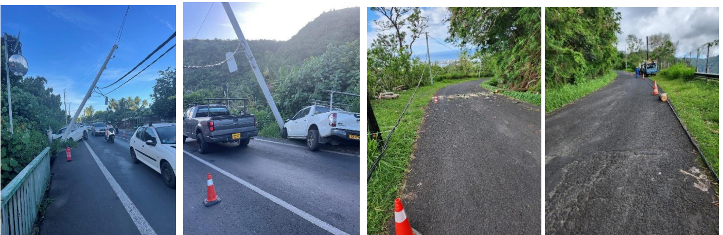
Accident sur le réseau HTA aérien causé par un tiers
