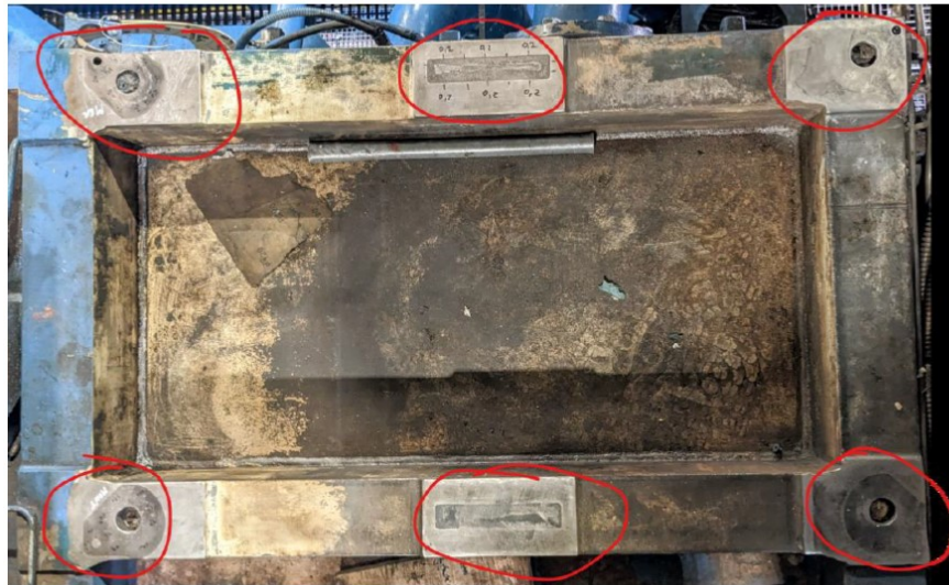
Surfaces d'appui du turbo sur le moteur usées
