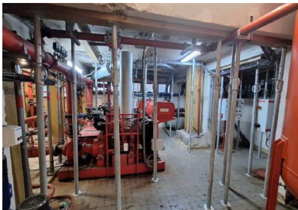
Local incendie groupes motopompes
