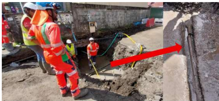
Figure 10 - Lieu de l'incident / constat sur site
