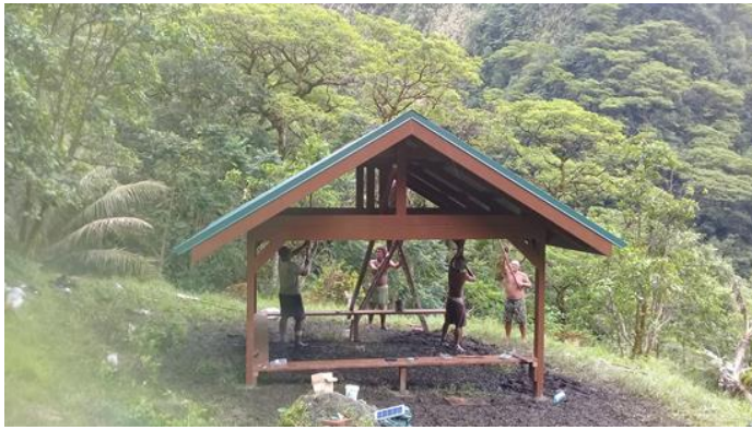
Illustration 50 : Construction d'un fare potee près du refuge 2 Te Faaiti (source ©service du Tourisme)
