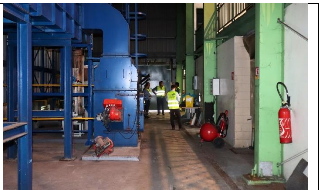
Figure 15: Incinérateur du CHPF à Nivee
