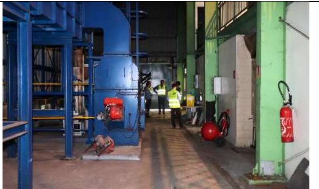
Figure 15: Incinérateur du CHPF à Nivee
